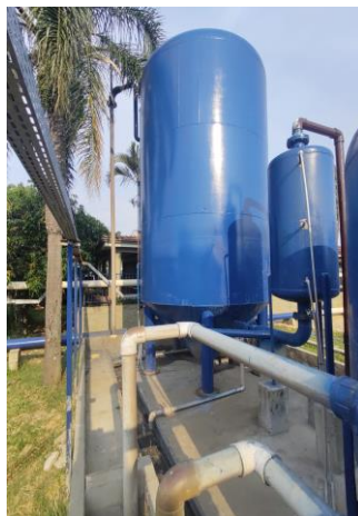
Figura 17 - Tanque de tratamento físico-químico
