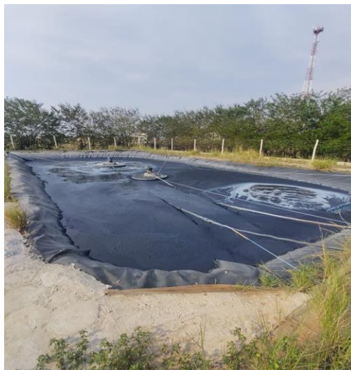
Figura 14 - Tanque de equalização
